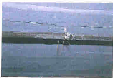
Bild 17: Noch vorhandenes PVC-U-Rohr in Bitterfeld, Parkstraße 18, aus der bis 1991 betriebenen und dann ersetzten Installation.
